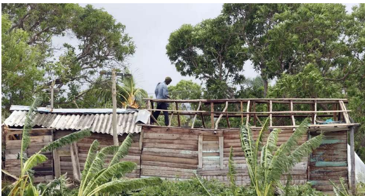
Los techos arrancados son uno de los daños más comunes entre las viviendas afectadas. / EFE
